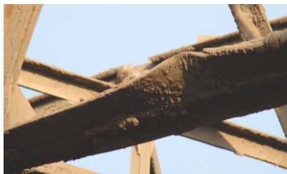
Рисунок 21 – Местное искривление в отстоящей полке уголка со стороны оси 3 четвертой от ряда Б панели нижнего пояса фермы Ф2
