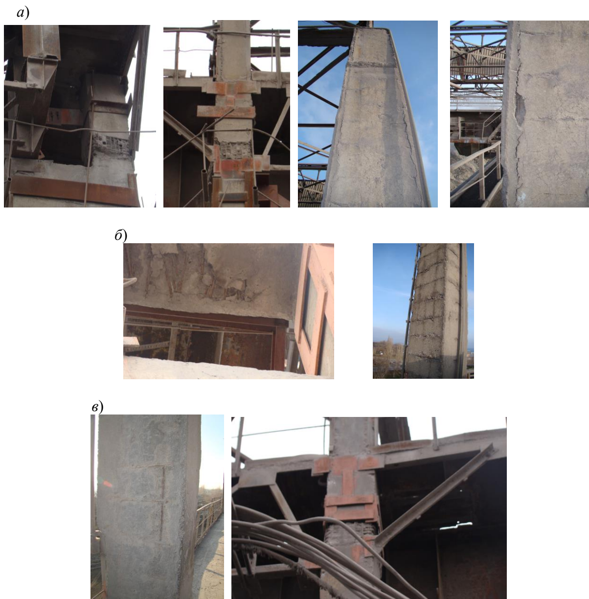
Рисунок 14 – Оголение рабочей арматуры
