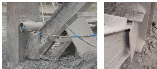
Рисунок 16 – Искривление фасонки и уголков решетки вертикальной связи между колоннами А/ 3-4 у оси 3 и фасонки вертикальной связи между колоннами А/ 3-4 у оси 4
