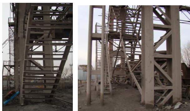
Рисунок 17 – Изогнутая и закрученная наружная ветвь вертикальной связи 7 между колоннами А/ 3-4 у оси 4 и нижняя диагональ вертикальной связи между колоннами А/ 5-6 у оси 5
