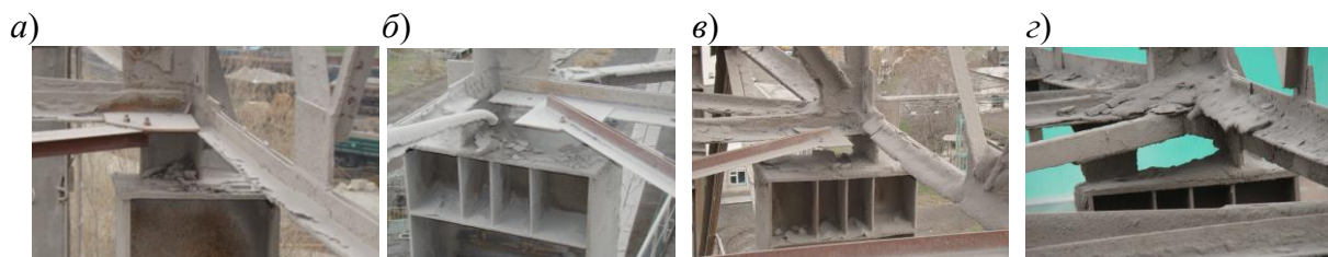
Рисунок 11 – Скопление затвердевшей пыли на оголовке колонны а) Б5 (вид со стороны оси 4); б) Б4 (вид со стороны оси 5); в) А4 (вид со стороны оси 5); г) А3 (вид со стороны оси 4)
