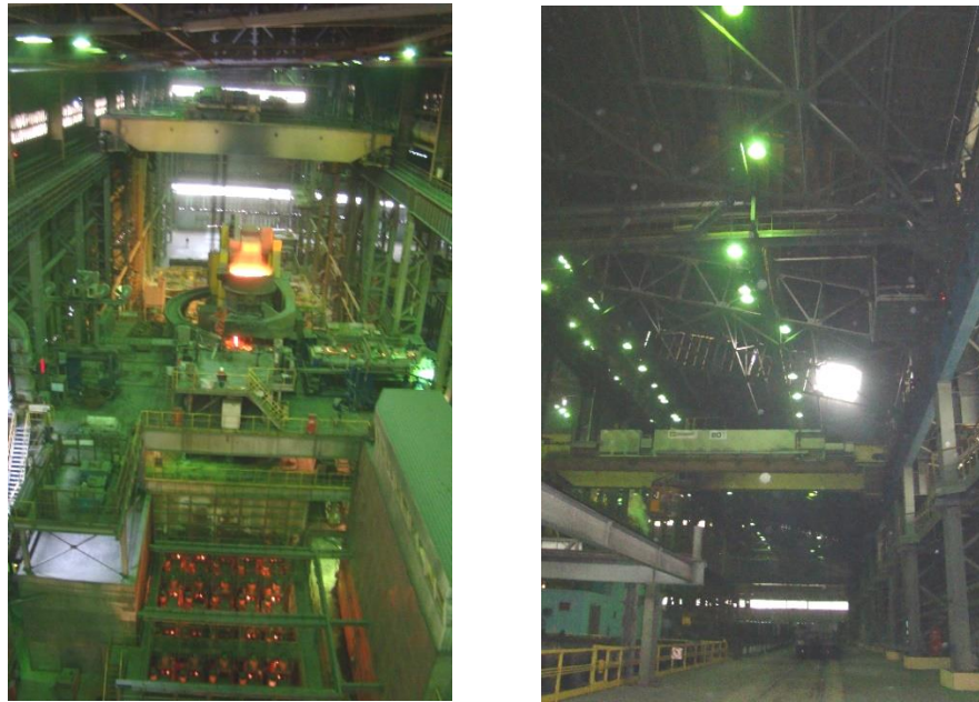
Б (В) А Б (В) В (С) Рисунок 9 – Мостовые краны в пролетах А–Б и Б–В здания ОНЛЗ
