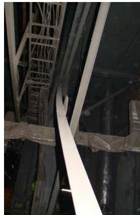
Рисунок 20 – Искривление и отрыв диагоналей вертикальной крестовой связи между стойками рабочей площадки по ряду А между осями 9'–10'
