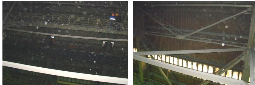
Рисунок 17 – Общее искривление распорок горизонтальных связей по нижним поясам ферм Ф7' – Ф8' пролета Б–В и местное искривление диагонали горизонтальной связи у А11' по нижним поясам ферм Ф11' – Ф12' пролета А–Б
