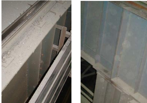
Рисунок 19 – Отсутствие трех горизонтальных болтов в месте стыка подкрановых балок на колонне А7' и двух горизонтальных болтов – на колонне Б8'
