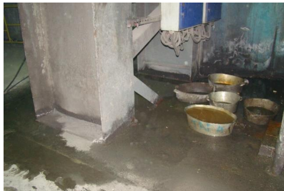
Рисунок 15 – Намокание основания колонны А9'
