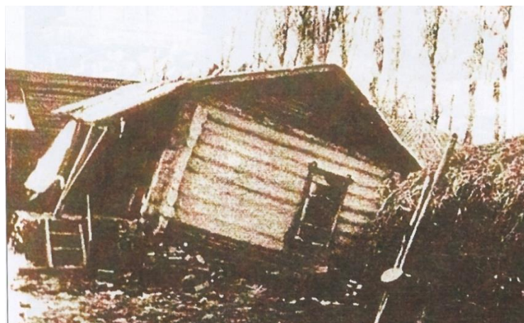
Рисунок 4 – Последствия Кеминского землетрясения на территории г. Верный (ныне Алматы). При землетрясении в грунте образовалась обширная трещина, вызвавшая разрушение фундамента здания
