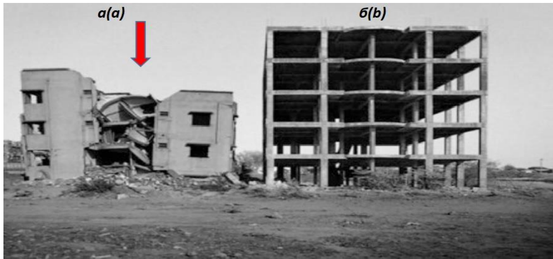
Рисунок 13 – Два здания с железобетонным каркасом в г. Бхудж, Индия, после землетрясения в штате Гуджарат в 2001 г.: a – здание с ж/б каркасом и каменным заполнением; б – здание с ж/б каркасом без каменного заполнения
