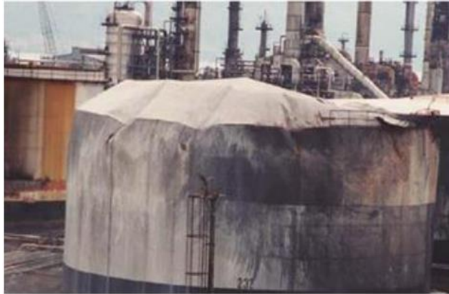
Рисунок 5 – Сгоревший резервуар со стационарной крышей. Коджаэли, Турция, 1999 г. [16]
