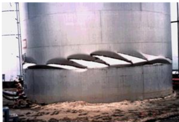
Рисунок 3 – «Ромбовая» деформация небольшого резервуара. Кобе, Япония, 1995 г. [10]
