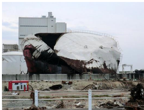
Рисунок 8 – Резервуар, разрушенный цунами. Япония, 2011 г. [18]
