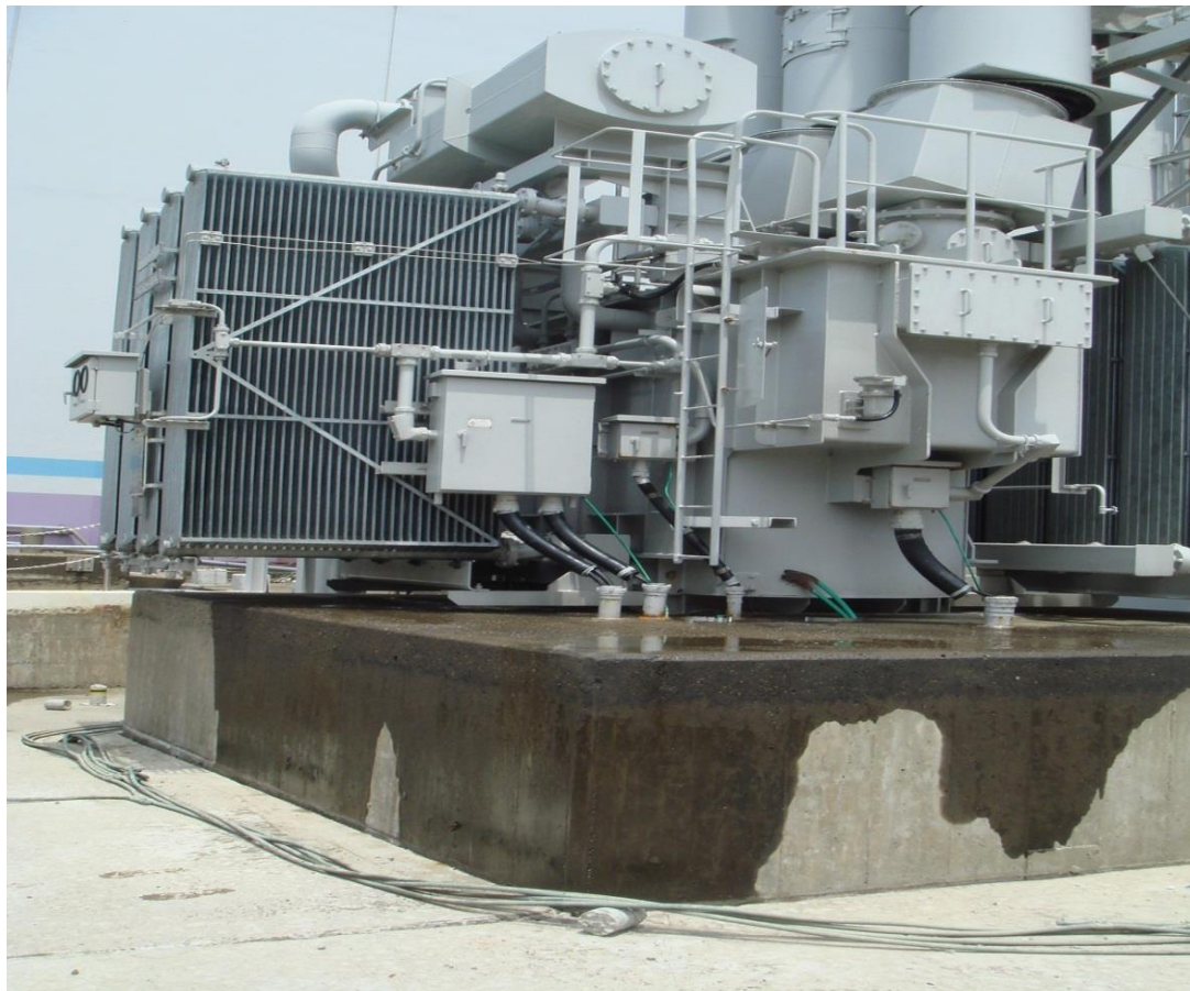
Рис.5. Утечка масла из трансформаторов на АЭС вследствие землетрясения. Фото компании ТЕРСО (Япония)
