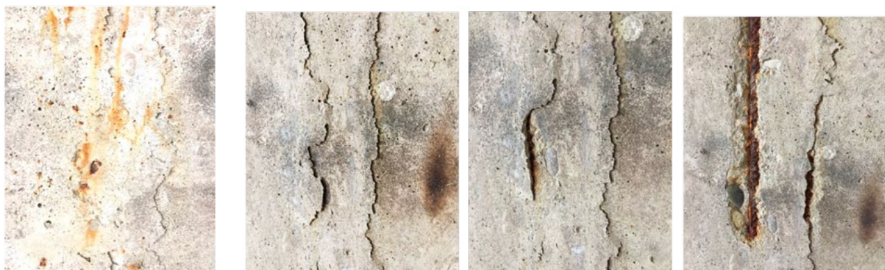
Рисунок 1 — Процесс развития коррозии арматуры и разрушение бетона Figure 1 — Process of reinforcement corrosion development and concrete destruction
